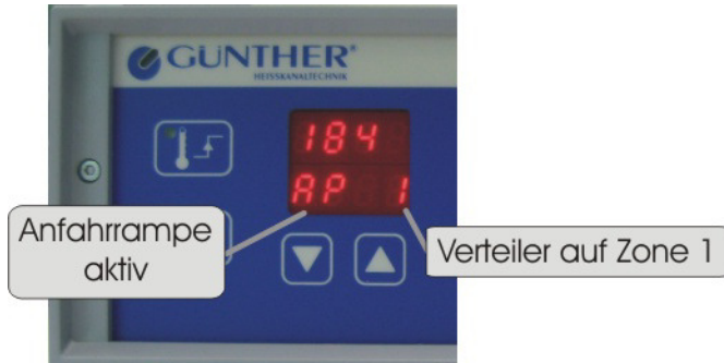
Abb. 4.1 Anfahrrampe erkennt Verteiler auf Zone 1
